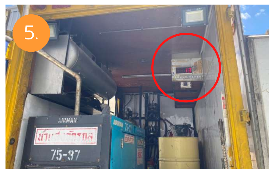
5. เมื่องานแล้วเสร็จ เจ้าหน้าที่จะทำการปิดรูเจาะด้วยซีเมนต์แบบไม่หดตัว และทำการสรุปปริมาณวัสดุที่ใช้โดยตรวจสอบได้จากมิเตอร์วัดปริมาณวัสดุ
