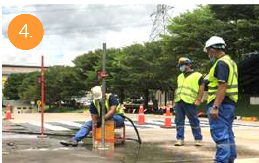
4. ทำการฉีดสารโฟลียูรีเทน โดยเจ้าหน้าที่ผู้เชี่ยวชาญ เป็นผู้ควบคุมอัตราการยกตัว เพื่อป้องกันการแตกร้าวของคอนกรีต
